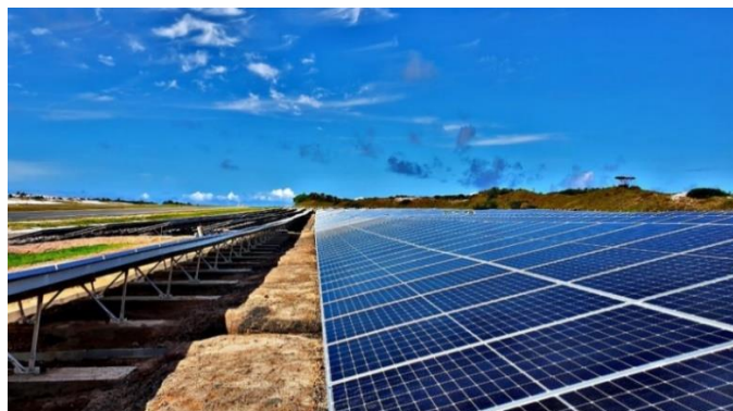
Figura 16 – Painéis solares na cabeceira da pista do Aeroporto de Salvador
