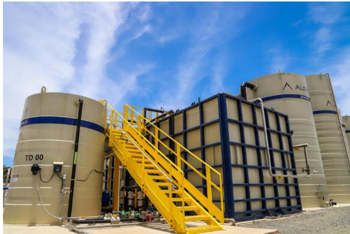
Figura 17 – Nova Estação de Tratamento de Efluentes do Salvador Bahia Airport
